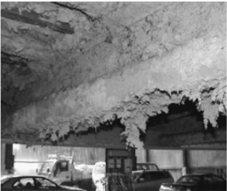
露出したアスベスト
